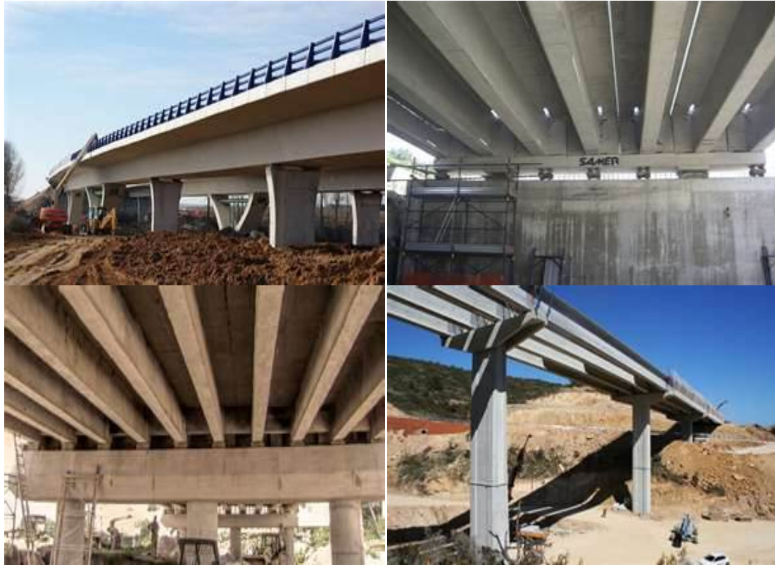
Image 3-9. Différentes typologies de ponts préfabriqués avec poutres de pètrin o sur I
